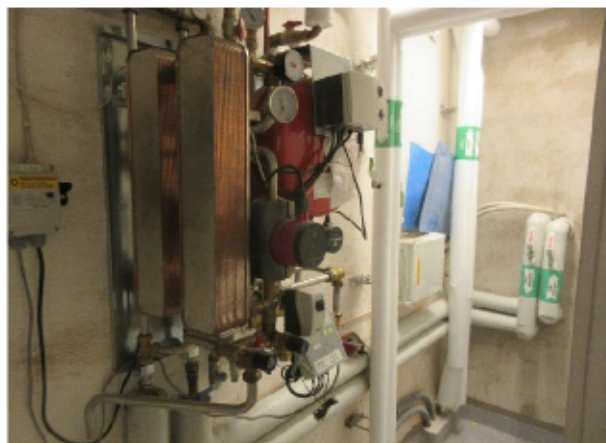
Undercentral för värme och varmvatten.
