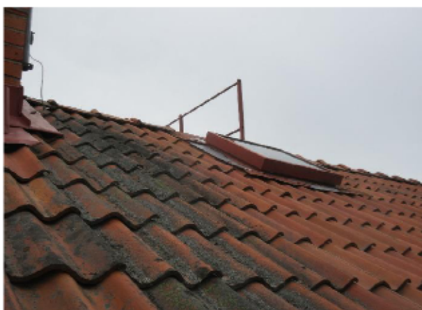
Taklucka vilken är igensatt från insidan
